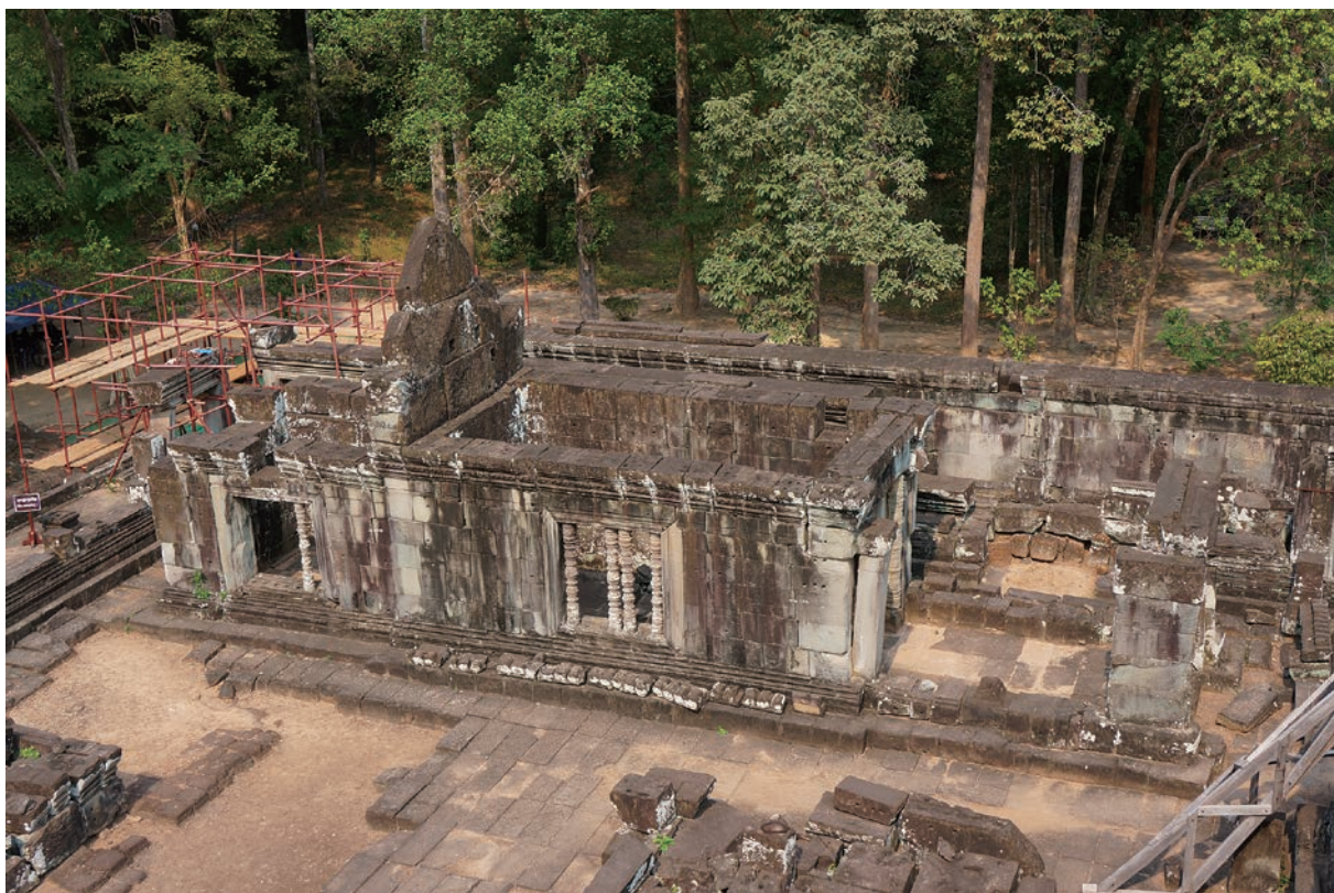
北内长厅维修前
